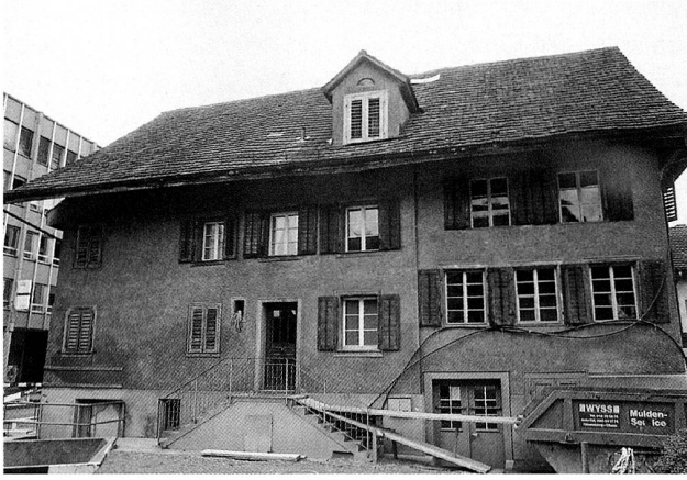
Abb. 2 Baar, Dorfstrasse 8. Aussenfassade mit der Trennung in Blockbau (links) und Ständerbauteil (rechts). Blick Richtung Südwesten. Zustand bei Untersuchungsbeginn.
