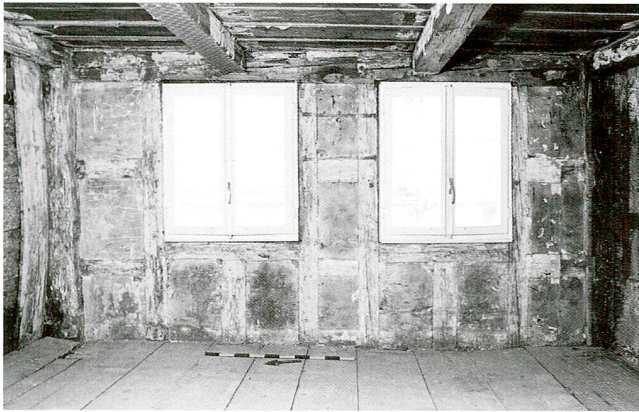
Abb. 11 Zug, Dorfstrasse 2. Erstes Obergeschoss, Raum 13, Ostwand. Riegelkonstruktion mit gemauerten Ausfachungen. In den Raumecken sind noch Fassadenständer des Bohlenständerbaus zu erkennen.
