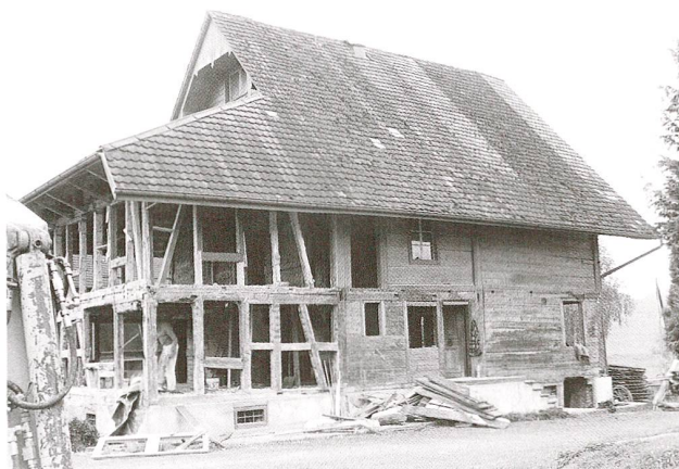
Abb. 6 Cham, Niederwil, Haus Wismer: Ostecke des Hauses, Zustand August 2002. Rechts unter dem Satteldach der Hauskern (Bohlen-Ständer-Bau, Anfang 18. Jahrhundert), links der junge Anbau als Skelett.
