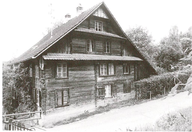
Abb. 17 Walchwil, Vorderbergstrasse 37, «Försterhaus». Ostfassade, mit Flickstellen besonders im Erdgeschoss (etwa neben dem mittleren Fenster oder links des linken Fensters). Zustand Mai 2002.
