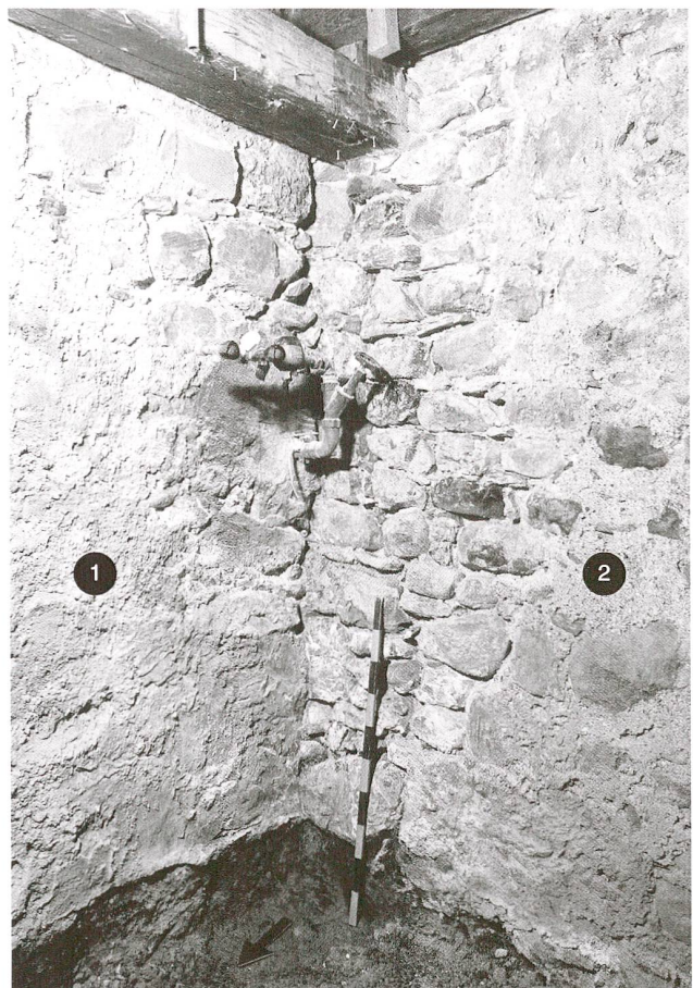
Abb. 22 Zug, Grabenstrasse 22. Untergeschoss. 1 Ostmauer (Stadtmauer) mit Vormauerungen. 2 Südmauer. Die Ostmauer stößt gegen die (vermeintlich jüngere) Südmauer an der Innenseite der Stadtmauer. Für beide Mauern wurden Unterkanten bei ca. 422,7 m ü. M. festgestellt.
