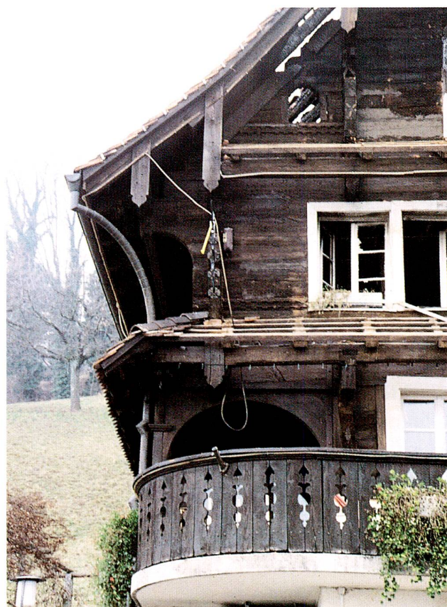
Abb. 37 Walchwil, Zugerstrasse 80, Restaurant Hörndli. Lauben, Vordächer und Zierformen an der seeseitigen Fassade, nach dem Brand. Blick Richtung Osten.
