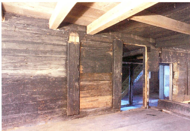
Abb. 11 Walchwil, Lauihof. Hinterstube (Raum 10) mit der ehemaligen, später zugebauten Türe, deren Pfosten als Mantelstüde ausgebildet waren. Rechts davon befand sich ein Ofen, dahinter die Küche (Raum 8) und zuhinterst die Treppe ins Obergeschoss. Blick nach Westen.
