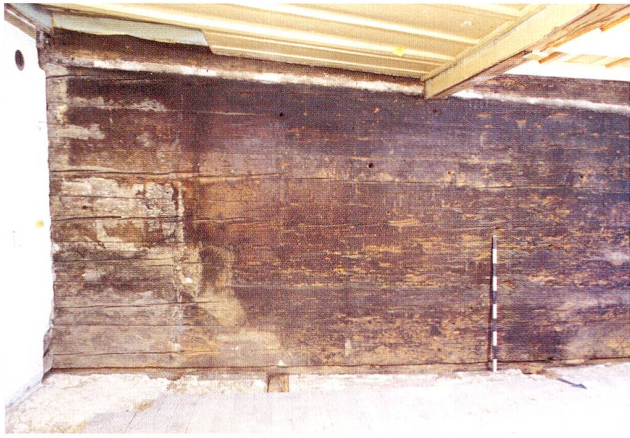
Abb. 33 Zug, Ägerstrasse 26, Restaurant Kreuz. Südwand der in Blockbautechnik errichteten Stube im ersten Obergeschoss. Links der ehemalige Standort des Kachelofens, davor der zum Teil freigelegte Mörtelstrich, oben die Nut der alten Decke.
