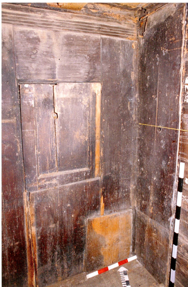
Abb. 7 Oberägeri, Hintergrueben, Stube (Raum 4). Detailansicht der nördlichen Binnenwand mit der Aussparung für den ehemaligen Wandschrank («Pestfenster»). Über dem Wandschrank befindet sich ein mit Rillenfriess verzierter Auflagebalken der ehemaligen Bohlen-Balkendecke. Unten ein mit einem hellen Brett verschlossenes Negativ einer Sitzbank, ganz rechts die Bohlenwand hinter dem Bretttäfer.
