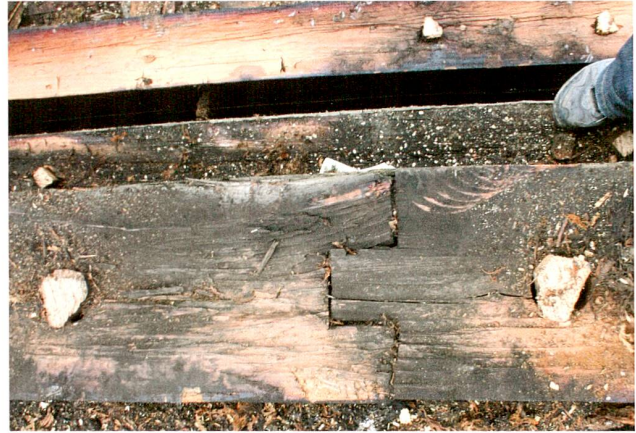
Abb. 31 Oberägeri, Grubenstrasse 37, Hintergrueben. An verschiedenen Stellen wurden Balken mit Anstückungen verlängert, wie hier an der Westwand der Dachkammer.
