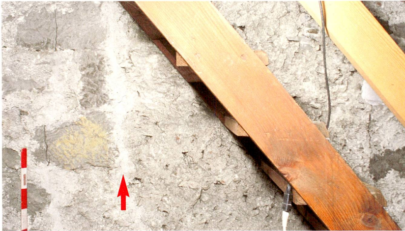
Abb. 58 Zug, Kolinplatz 12, Zitturm, erstes Obergeschoss. Zugemauerte und 1480 teilweise verputzte linke Laibung (Pfeil) aus Sandsteinquadern eines Schlitzfensters in der Südostfassade.
