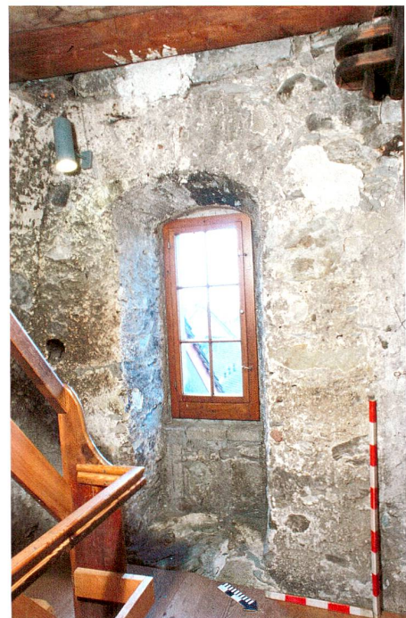
Abb. 61 Zug, Kolinplatz 12, Zitturm, viertes Obergeschoss. Vermutlich 1557 ins Mauerwerk von 1480 gebrochene (und nachträglich veränderte) Fensteröffnung in der Südwestfassade. Am linken Bildrand Reste des gewölbten Auflagers für einen Rauchabzug über dem ehemaligen Kochherd, am rechten Bildrand ein Rähmbalken mit Schwellenschloss der Turmwächterstube von 1557.
