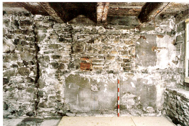
Abb. 70 Zug, Unteraltstadt 7. Nordwand im ersten Obergeschoss. Nordmauer des Steinbaus (links jüngeres Mauerwerk, rechts jüngere Ehgrabenmauer) und drei dazu gehörende, ins Jahr 1423 datierte Deckenbalken.
