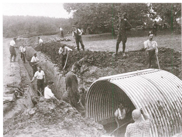
Abb. 9 Bau von Feldbefestigungen durch die Füsilierkompanie 1/48 im Bruderholz (26. August 1914). Um der Mannschaft einen besseren Schutz gegen Artilleriebeschuss zu bieten, werden Wellblechunterstände eingebaut und mit Erde überdeckt.
