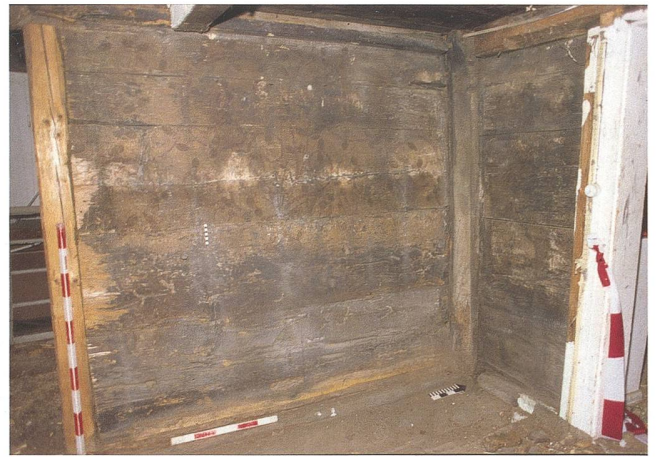
Abb. 6 Baar, Leihgasse 39/41. Nordwestecke der Stube vor dem Abbau. Der Eckständer zeigt keine Farbspuren.
