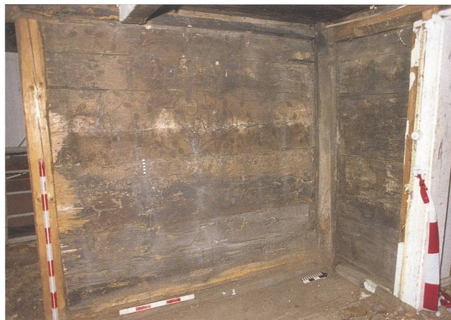
Abb. 6 Baar, Leihgasse 39/41. Nordwestecke der Stube vor dem Abbau. Der Eckständer zeigt keine Farbspuren.
