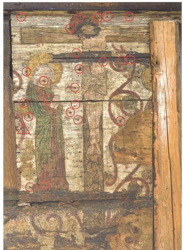
Abb. 5 Baar, Leihgasse 39/41. Stube, Westwand, Südteil. Kreuzigungsszene. Im Holz verbliebene Nägel (rote Ringe) und unter der Farbe liegender, wandebener Holzzapfen (rotes Dreieck). Die vielen Einstiche entlang des Kreuzschafes sowie auf und hinter Maria sind nicht speziell markiert.
