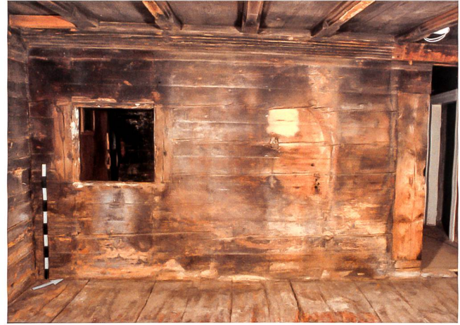
Abb. 2 Unterägeri, Haus Unterblacki. Blockbau aus dem 16. Jahrhundert. Westwand der Stube mit Bohlen-Bälkchen-Decke, Wandschrank («Pestfenster») links und Stubentüre mit Mantelstud rechts. Das Gebäude ist für die Erforschung der Konstruktions- und Lebensweise des 16. Jahrhunderts und der darauffolgenden Zeit von sehr hohem Wert.
