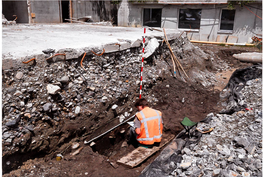
Abb. 23 Oberägeri, Überbauung «Zentrum Oberägeri». Profildokumentation am Nordostrand der Parzelle, Blick gegen Norden. Gut erkennbar ist die auf einem ca. 80 cm starken Geröllkoffer aufliegende, massiv armierte Bodenplatte der abgebrochenen Vorgängerbebauung. Im unteren Teil des Profils ist die zahlreiche Funde, u. a. das Pfeifenkopffragment, enthaltende, dunkelbraun-torfige Verlandungsschicht aufgeschlossen.
