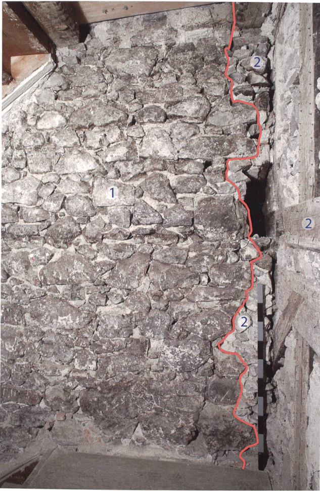
Abb. 8 Zug, Unteraltstadt 26. Dreigeschossige Verbindungsmauer, zwischen 1435 und 1676d, 1 Mauerwerk im Bereich erstes/zweites Obergeschoss. 2 Umbau von 1676d mit Fachwerkwand und zugehöriger Zumauerung. Blick nach Norden.
