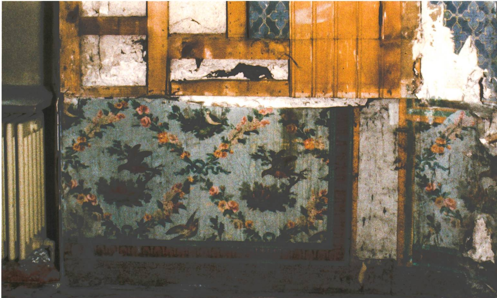
Abb. 14 Zug, Ägeristrasse 9, Hinterhaus, erstes Obergeschoss, Raum 2.13. Dekor von etwa 1790 aus drei Tapeten- und zwei Bordürenmustern, auf einem Gerüst aus Holzlatten. Die Tapete mit blauen Kreuzen und das Krallentäfer wurden später montiert. Tapeten und Bordüren: grundierte Bogenrolle, Handdruck, unbekannte Manufaktur, um 1780/1800.
