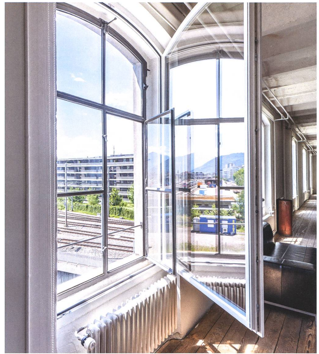
Abb. 4 Detail der Fensterertüchtigung: Das alte Gusseisenfenster wurde mit einem neuen, zusätzlichen Fensterflügel ergänzt.
