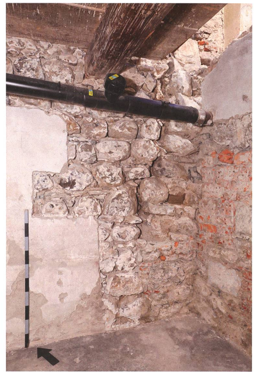
Abb. 2 In der nördlichen Brandmauer erhaltener Rest der Stadtmauer mit anstossendem Kernbau des Hauses Grabenstrasse 32. Blick nach Osten.
