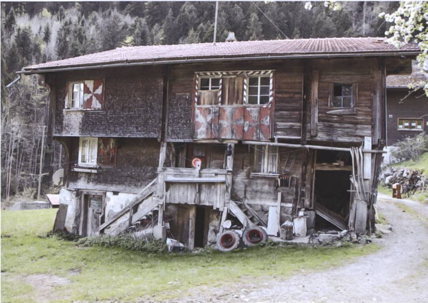
Abb. 2 Das «Wyssighaus» im Isenthal wurde vor seiner Demontage für einen Wiederaufbau an einem neuen Standort bauarchäologisch untersucht. Die dendrochronologische Datierung ergab ein Fälldatum im Winterhalbjahr 1787/88. Blick auf die östliche Trauffassade.
