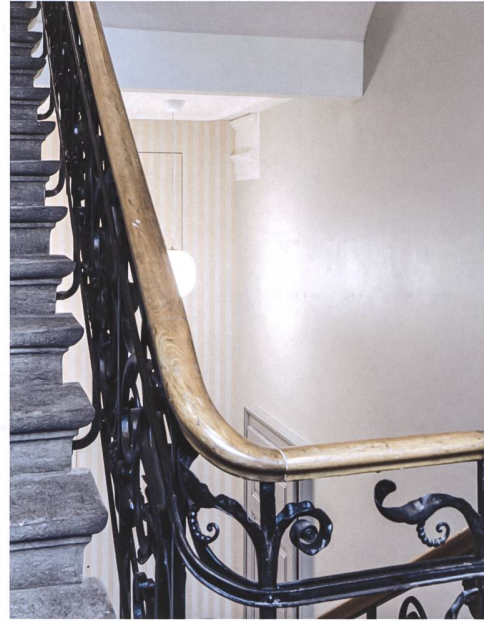
Abb. 4 Treppenhaus mit Blick von Osten auf die neue Liftwand mit gestreifter Caligot-Tapete und Wandstuckresten.
