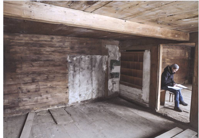
Abb. 3 Im Rahmen der Dienstleistungsvereinbarung zwischen Uri und Zug wurde 2013 das «Wyssighaus» im Isenthal durch Mitarbeitende des Amts für Denkmalpflege und Archäologie Zug dokumentiert. Blick in die Stuben, im Hintergrund Anette JeanRichard(-Bieri) während der Kurzdokumentation.
