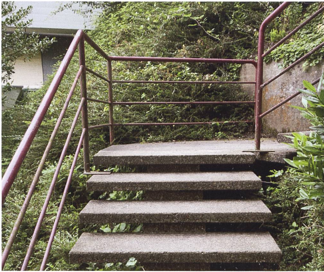
Abb. 3 Eine schlichte Bauweise prägt die Architektur: Holmentreppe mit frei fliegenden Trittstufen, Geländer aus verschweissten Rundrohrprofilen, ursprünglich feuerverzinkt.
