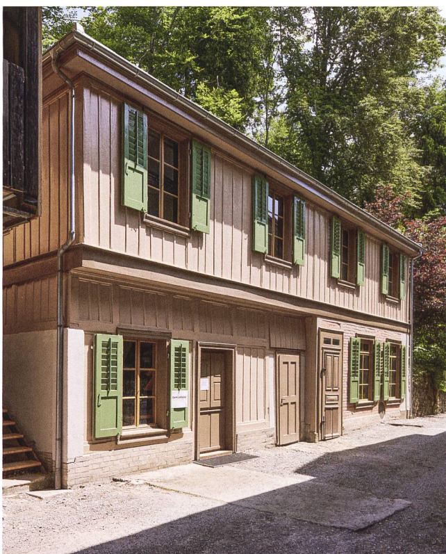
Abb. 29 Menzingen, Schönbrunn, Werkstattgebäude. Ansicht von Nordwesten. Bei der sanften Restaurierung des Gebäudes wurden nicht nur Mauerwerk und Holzverschalung saniert und repariert, sondern auch Türen, Fenster, Fensterläden und Gitter blieben erhalten und wurden nach historischem Befund wieder neu gefasst.
