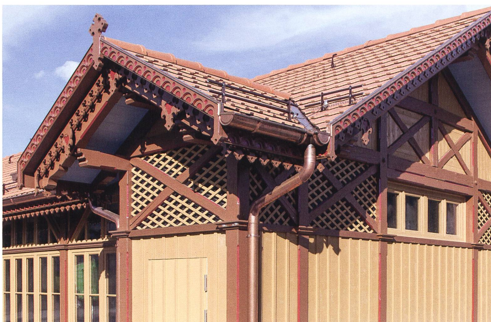
Abb. 50 Zug, Zugerberg, Schönfels 5. Das Holzwerk wurde sorgfältig demontiert und nach der Restaurierung in der Werkstatt, um nötige Ersatzteile ergänzt, vor Ort wieder aufgebaut.
