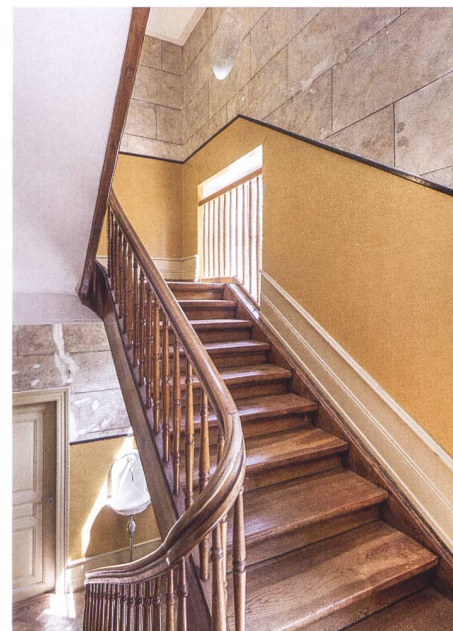
Abb. 2 Diese aufwendige Stein- bzw. Marmorimitationsmalerei wurde 2015 unter jüngeren Farbschichten entdeckt.
