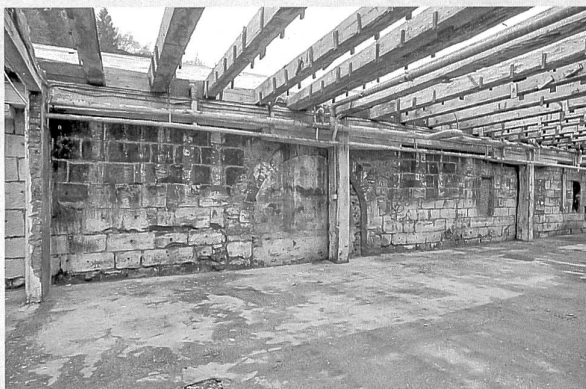
La façade nord, vestige du premier Werkhof, 1416-1417, avec la porte de 1556 et la poutraison de 1824 au-dessus
