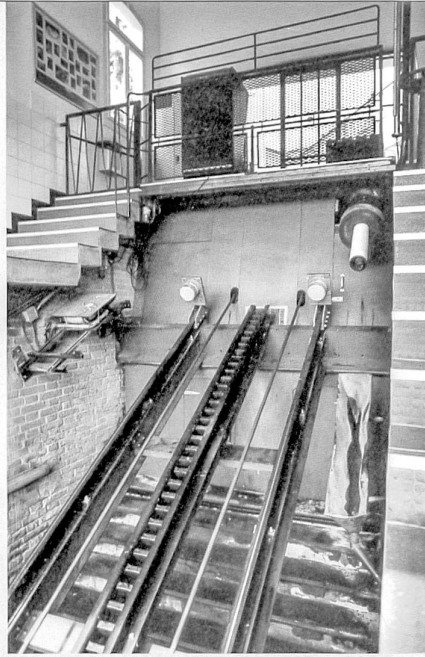
La station supérieure avec sa buse de remplissage
