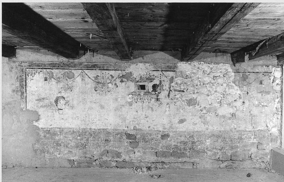
Fragments du décor peint de la salle sud du 2 e étage, 1608-1610, avec faux socle appareillé et festons
