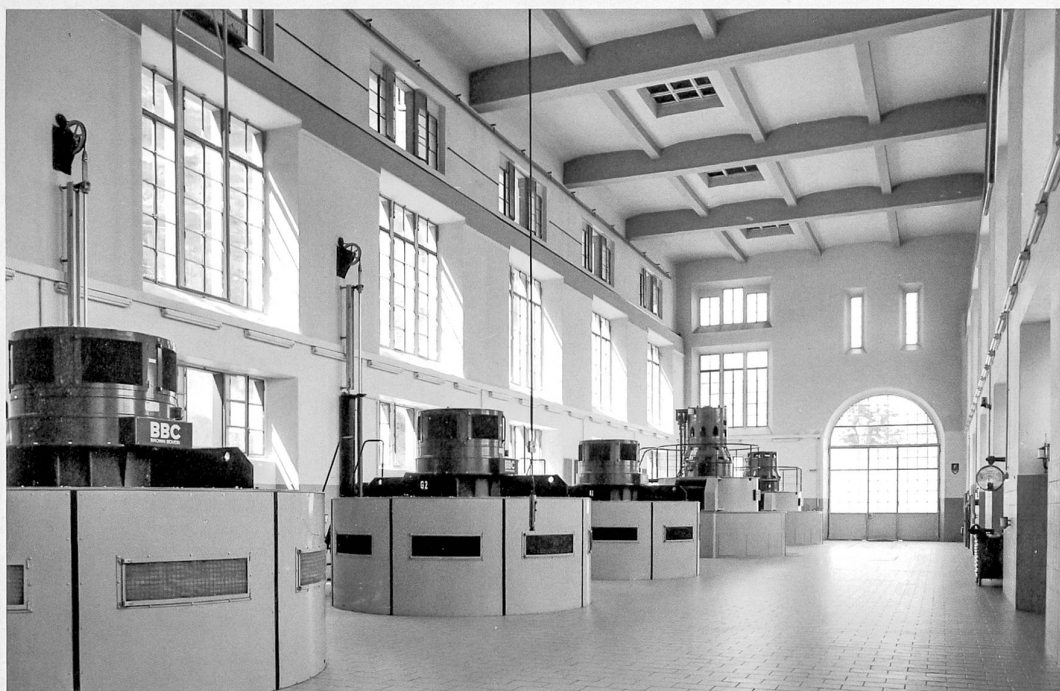
La nef de la salle des machines, cathédrale industrielle, avec ses cinq génératrices, état actuel
