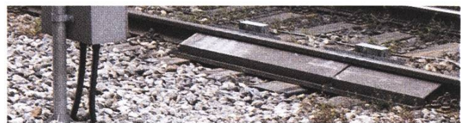
Spurkranzschmieranlage in Stadelhofen
