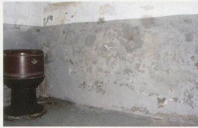
Schäden durch feuchte Mauern
