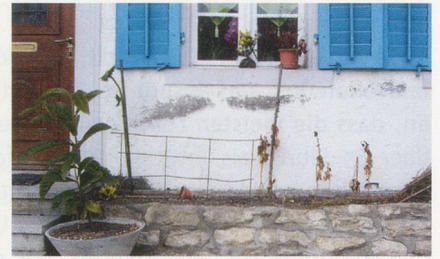
Abhilfe bei aufsteigender Mauerfeuchtigkeit – ohne Chemie
