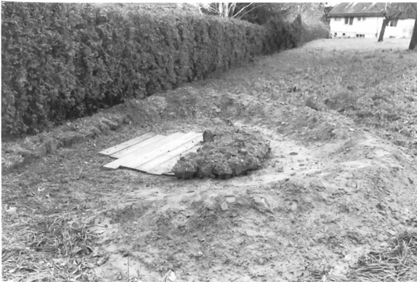
Abb. 31 Die Grubenöffnung ist mit Brettern und zur Hälfte mit Rasen- ziegeln überdeckt; der Damm gegen Oberflächenwasser ist angelegt.
