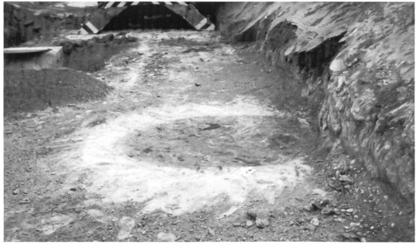
Abb. 1 Verfärbung der Grube 1 im Trasse der Titlisstrasse.
