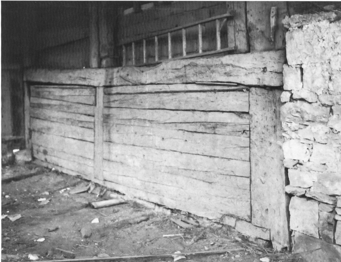
Abb. 33 Wölflinswil, Bodengasse 54. Ständerkonstruktion von 1562. Die Ständer stehen auf einem Schotterstreifen und auf Steinblöcken. Ein Ankerbalken auf Brusthöhe hält die Konstruktion zusammen.
