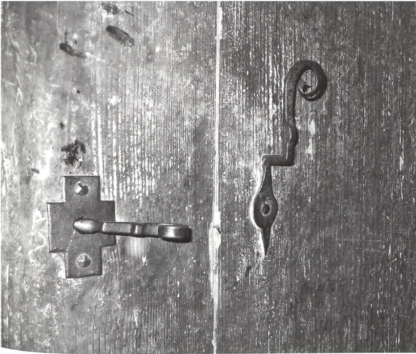
Abb. 20 Doppelhaus Frick, Kirchmattweg Nr. 5. Kunstvoll geschmie- deter Türgriff an Kam- mertüre im Ober- geschoss.
