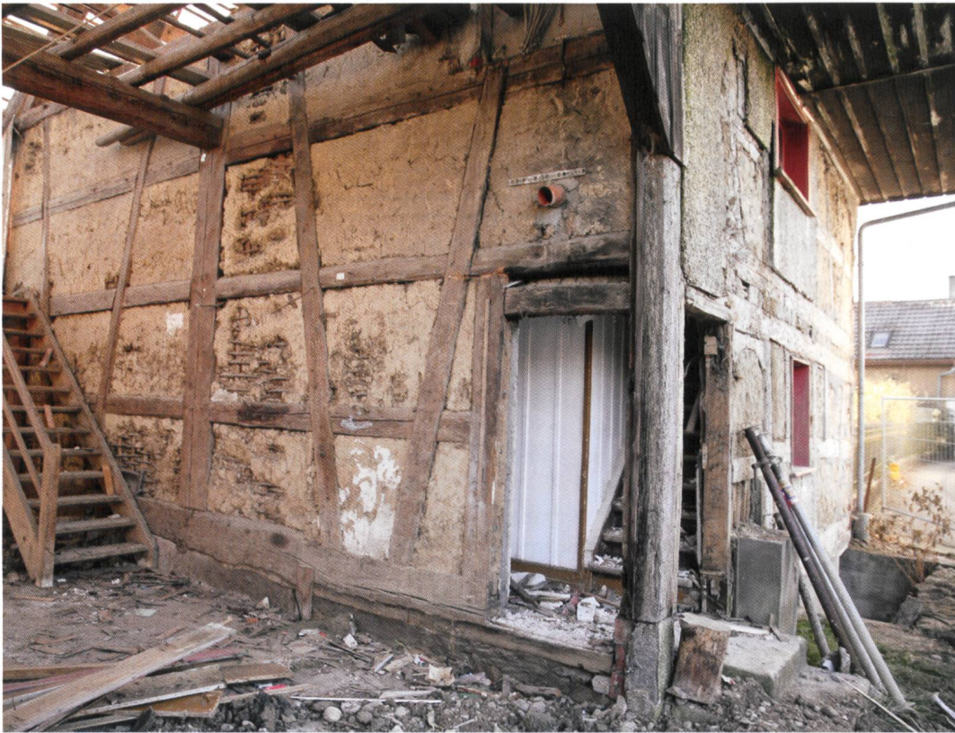
Abb. 4 Nordwestfassade und Trennwand zwischen Wohntrakt und Tenne während des Ab- bruchs. Während die Nordfassade stock- werkweise abgebun- den war, wies die Trennwand durchge- hende Ständer auf.
