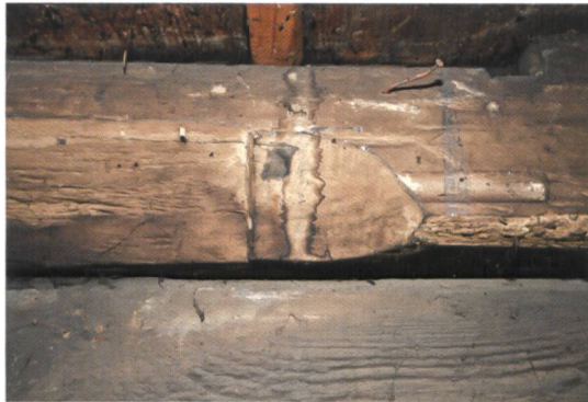
Abb. 4 Beispiel einer breiten, nachgotischen Fase in der Schlafkammer des 1548 errichteten Hochstudhauses am Blumenrain 2/4 in Othmarsingen. (C. Gut)
