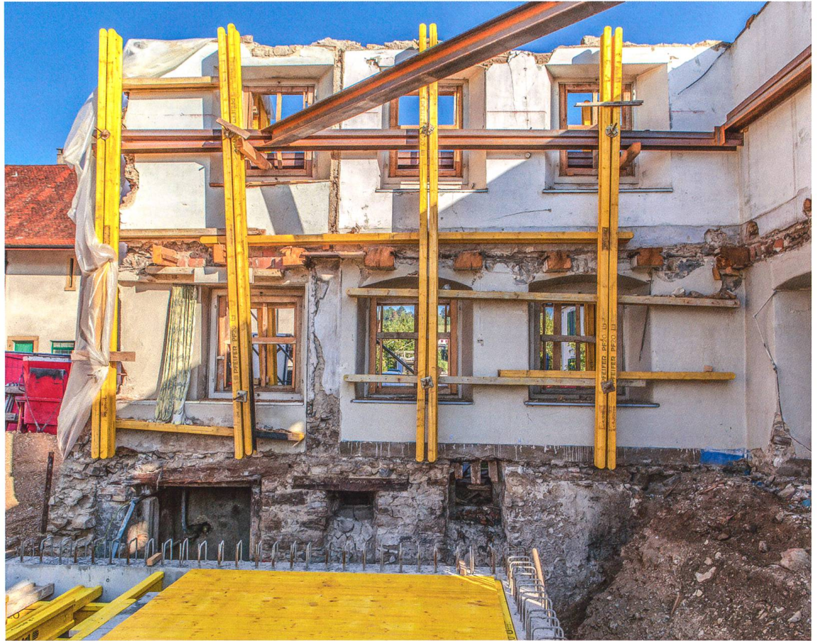
Abb. 1 Alles nur Fassade. Beim Abbruch wurden nur die zwei nördlichen Aussenwände und die Laube stehen gelassen.
