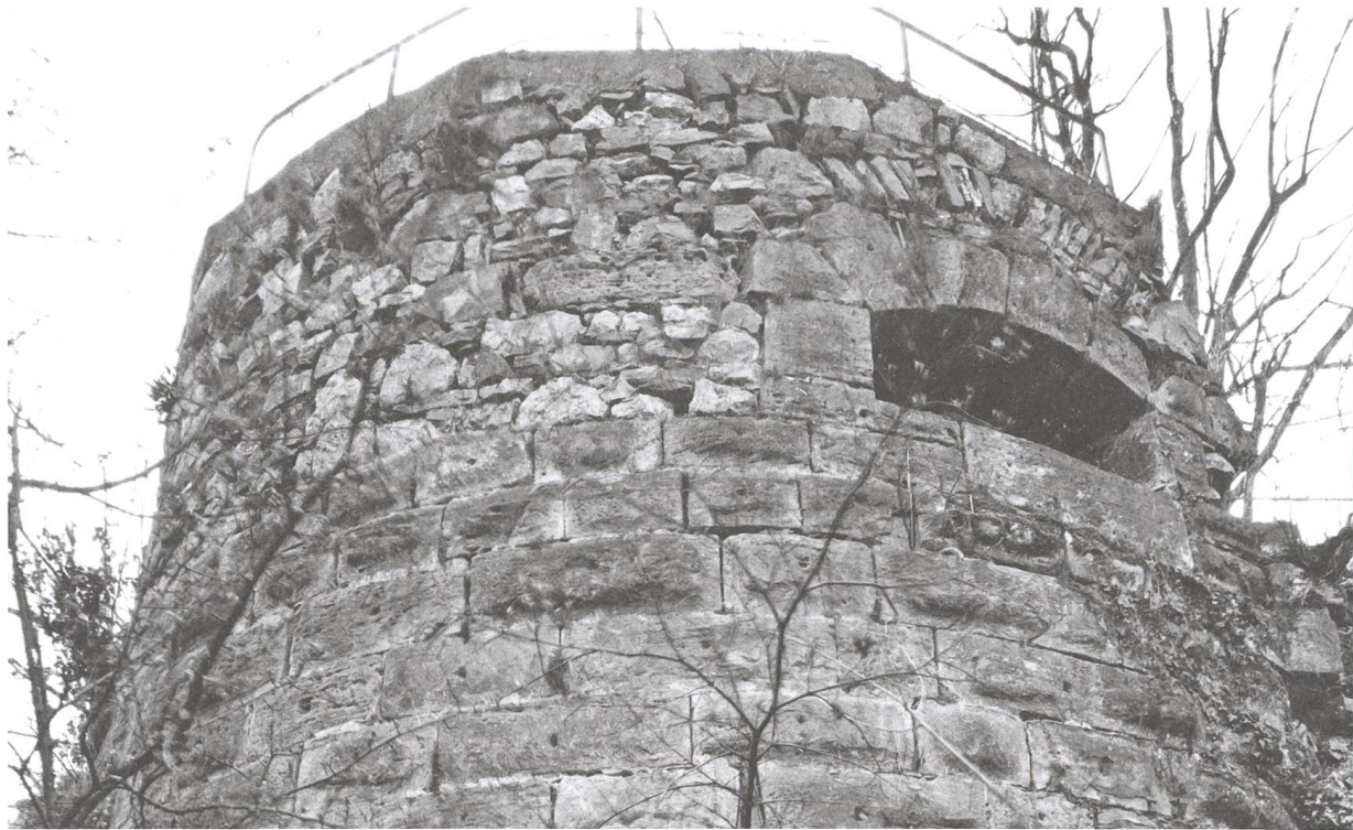
Abb. 6 Schlossberg. Stumpf des massiven runden Geschützturms, der gegen Ende des 15. Jh. an der Nordostecke der Kernburg erstellt wurde. Eine Schiesscharte mit breiter stichbogiger Öffnung ist erhalten. Der Turmstumpf ist im Volksmund als «Känzeli» bekannt.
