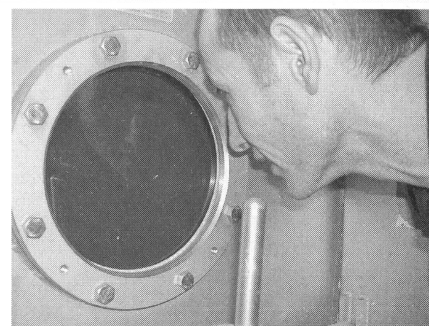
In einem Nebenraum der Schwimmhalle prüft Bieri die Qualität des Badewassers durch die Luke und führt Kontrollbuch. Er bedient und unterhält die technischen Einrichtungen und die Wasseraufbereitungsanlage.
