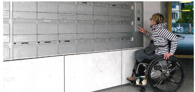
Hindernisfreie Gegensprechanlage bei einem Mehrfamilienhaus.
