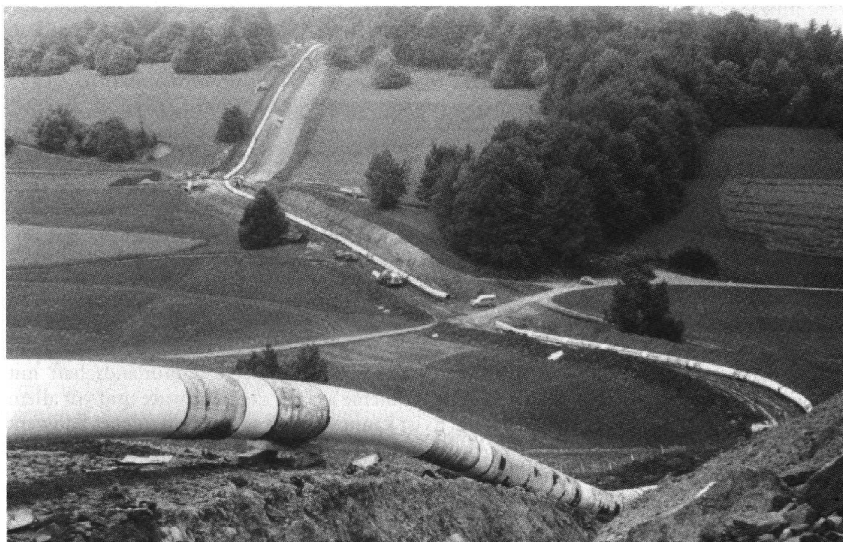
Fig. 1 Gasleitung bereit um verlegt zu werden. Schafmatt, Gemeinde Oltingen, BL. Koordinaten der Kreuzung Strasse/Pipeline. Landeskarte 1: 25 000, Blatt 1089 Aarau: 638.120/252.350. Aufnahme Richtung NW 24. Juli 1973.
