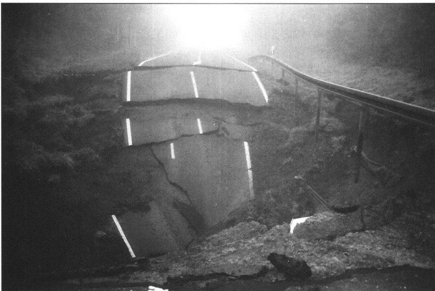
Fig. 9: Nachbruch des Erd-falles auf der B 180 im Oktober 2001 mit vollständiger Zerstörung der Fahrbahn (Foto: Dauterstedt).
