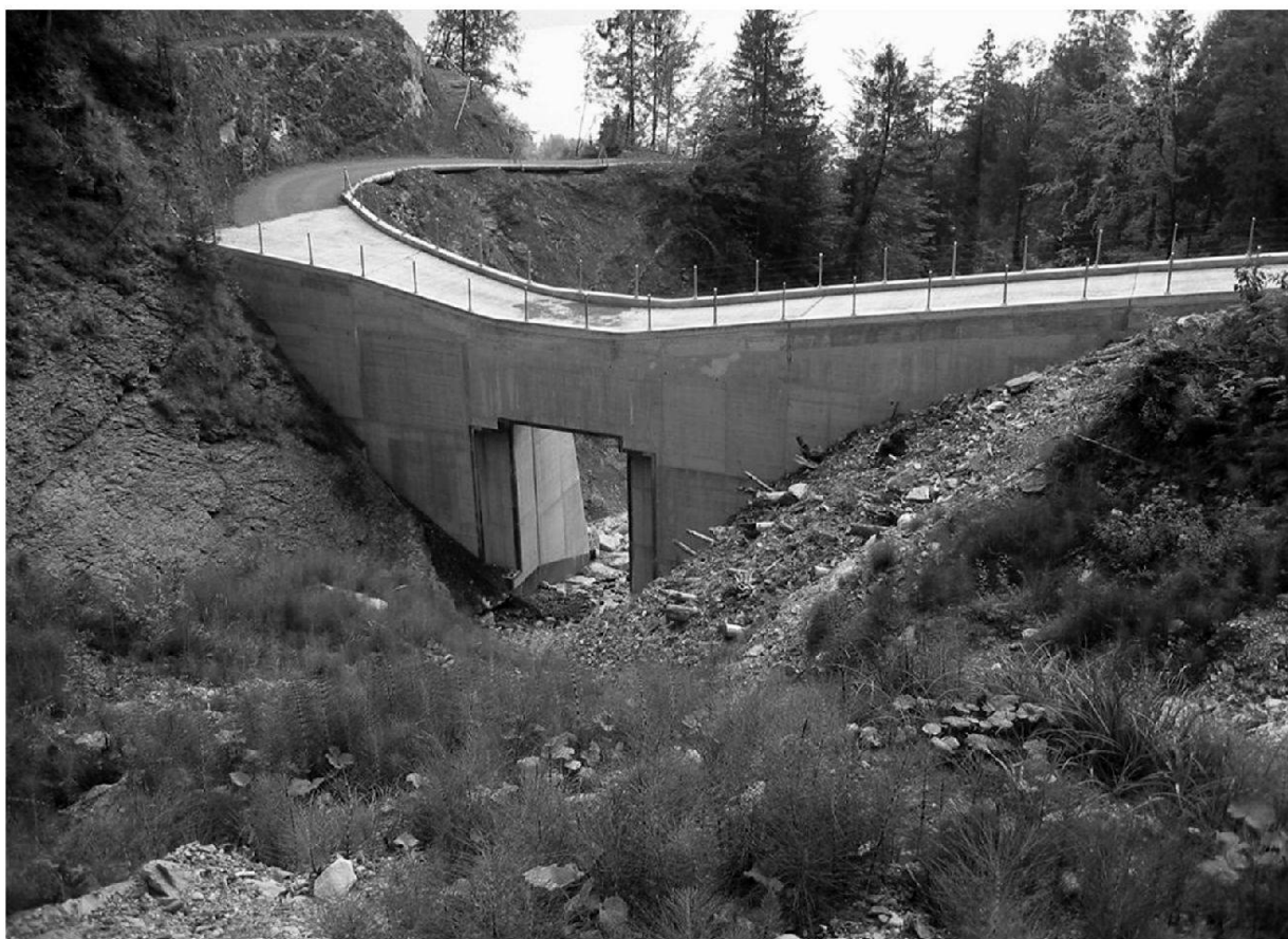
Fig. 1: Barrage filtrant en béton armé à l'aval immédiat de la zone instable à Hinter Ritzgraben.
