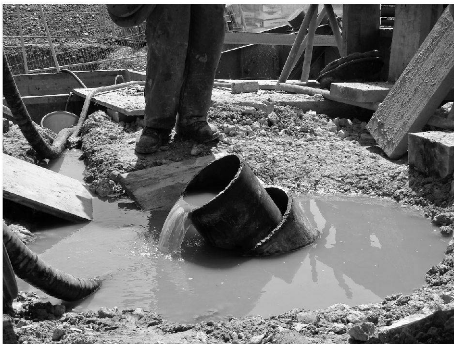
Fig. 8: Venue d'eau artésienne sortant du tubage 9"5/8.
