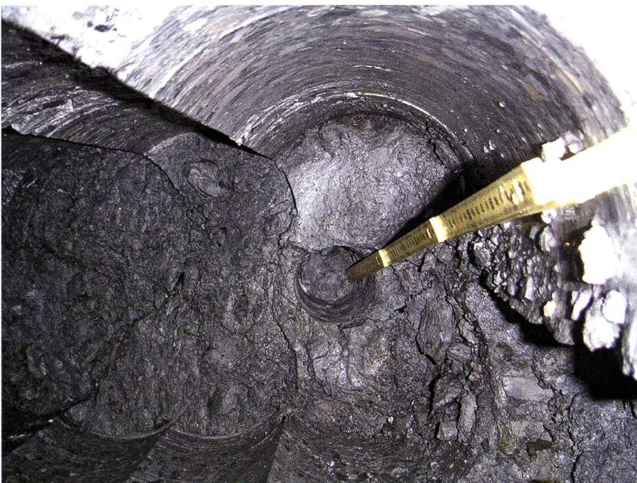
Fig. 3: Ansicht der verlehmtten Schiefer («alpiner Opalinuston», Mols-Member) im aktiven Rutschhorizont, horizontale Bohrung durch den Hauptschacht der Tiefendrainage «Grantenboden» (Foto: S. Frank, 2004).
