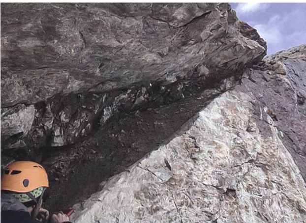
Fig. 9: Blick nach Norden in die markante durchschlagende Scherzone welche den Aletschgang unterquert.
