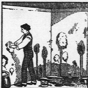
Wasserdurchlässige Stellen in Böden und Wandputz werden mit schnell- bindender „SIKA“ verdichtet.
