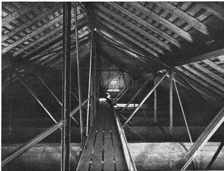
Abb. 3. Blick in den Dachraum über der Synagoge. (Ausführung der Eisenkonstruktion durch die Firma Löhle & Kern A. G., Zürich.)
