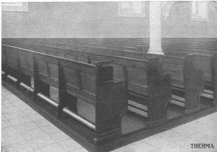
Abb. 1. Fussbankheizung. Unter der hintersten Bankreihe ist das Heizrohr sichtbar, unter den vordern Reihen sind die Rohre durch Holzlatten verdeckt.
