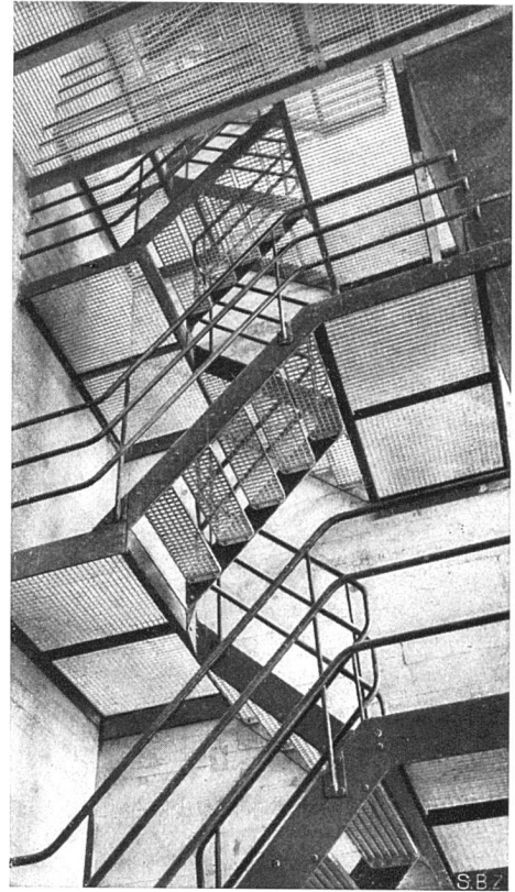
«Wema»-Treppe im Kesselhaus, durchsichtige Roste
