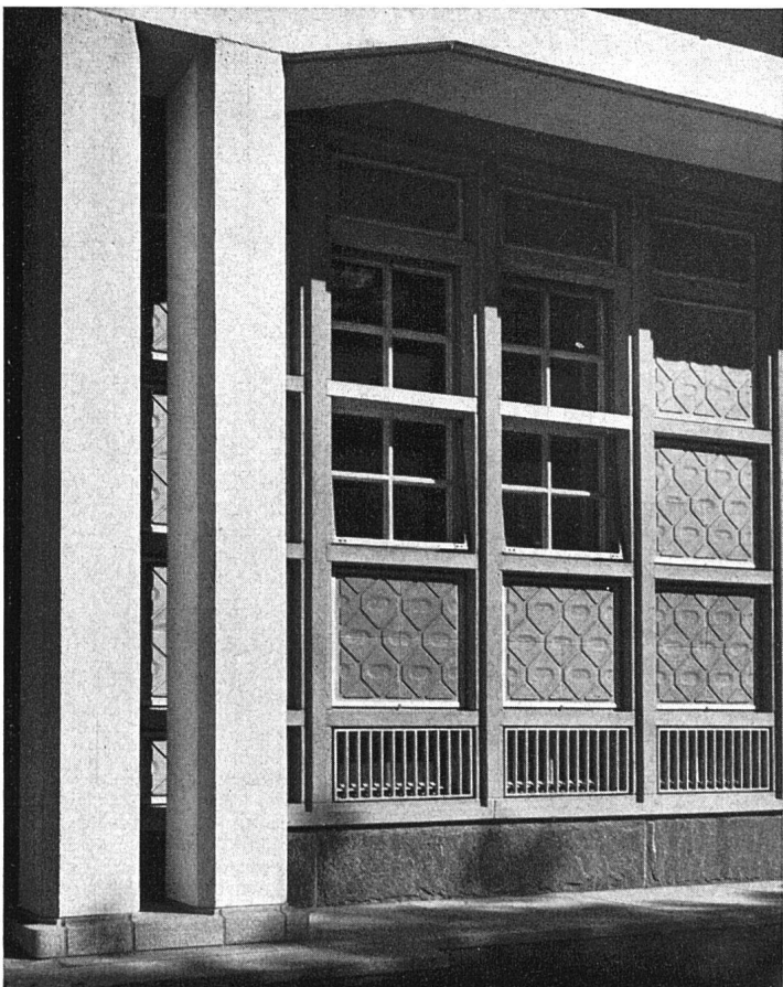
Abb. 38 Teilansicht der nichttragenden Außenwand des Geschosses A mit Betonraster. Füllungen mit Klinkerplatten verblendet
