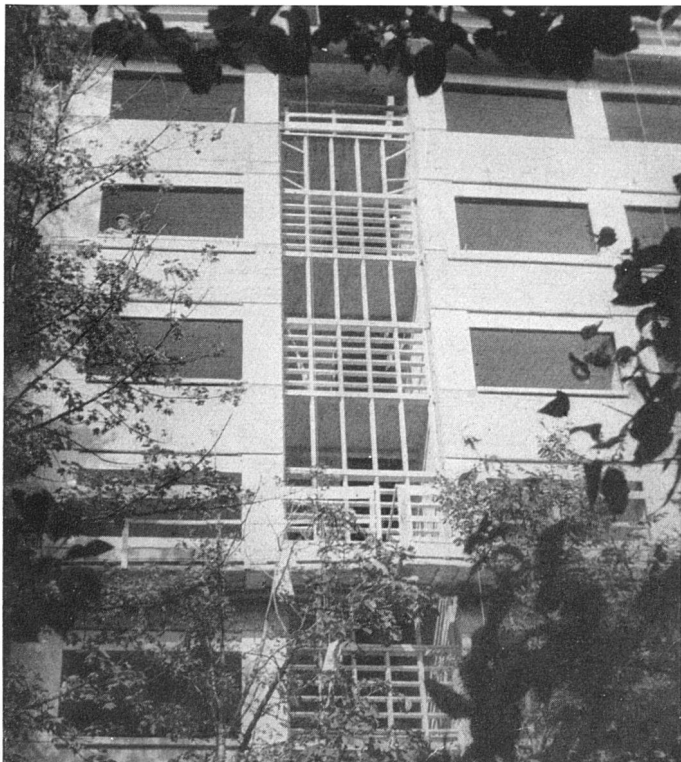
Groupe L, vitrage d'escalier en éléments préfabriqués / Wohnblock L, Treppenhausfenster aus vorfabrizierten Betonelementen / Block L, staircase window made of prefabricated units
