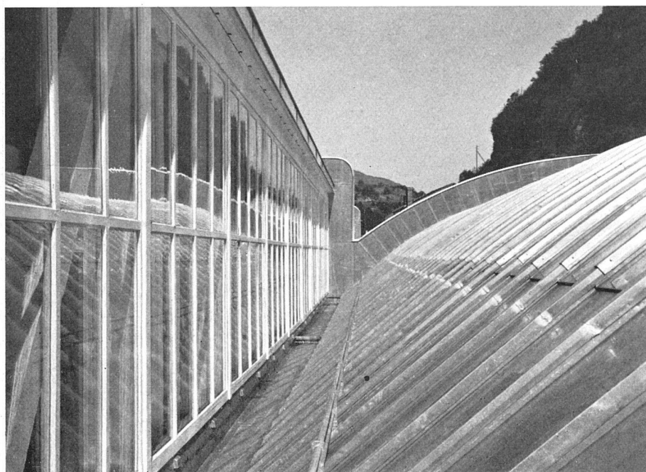
Detail der Sheds mit Regenrinne / Détail des «sheds», avec gouttière / Detail of the roof with rain-pipe
