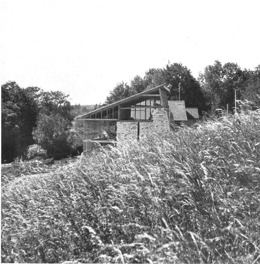
Südost-Ansicht während dem Bau | La maison en construction | The house during construction Photo: Marianne Gisel, Zürich
