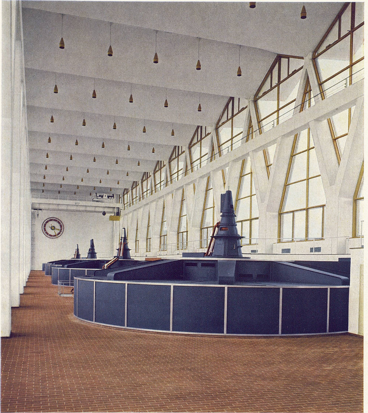
15 Der Maschinensaal Salle des alternateurs Interior of the power house
