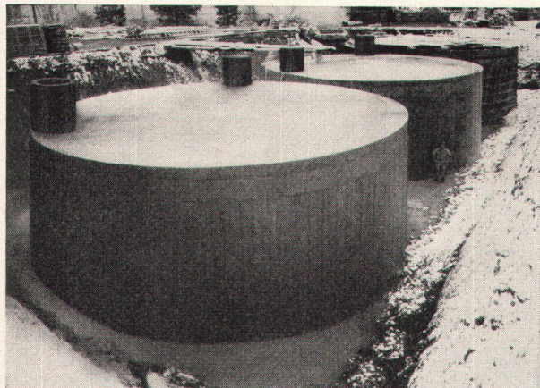
Tankanlage für ein kantonales Elektrizitätswerk, Inhalt 600 000 Liter
