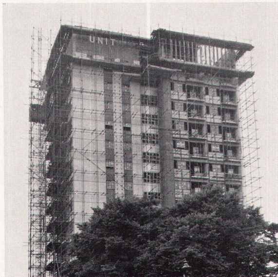
3 Wohnhaus in Kensal, London 1960 Immeuble locatif à Kensal, 1960 Flats at Kensal, London 1960
