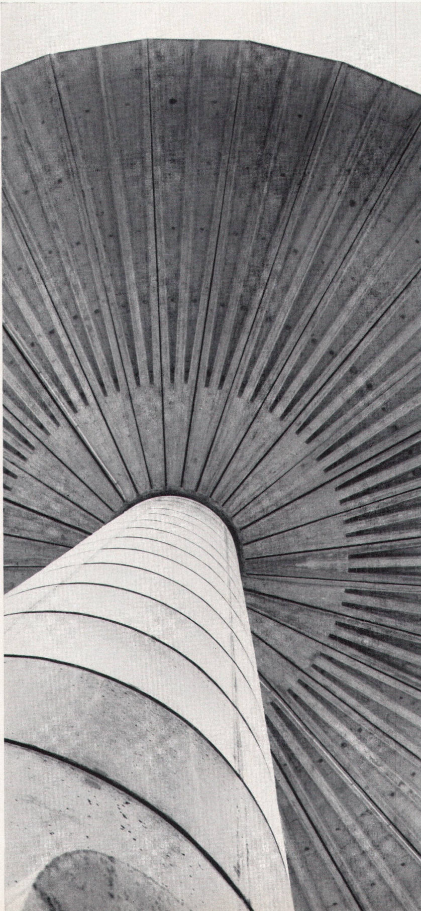
1 Modell des Wasserturms aus vorgefertigtem Beton Maquette du château d'eau en béton préfabriqué Detail of precast concrete water tower
