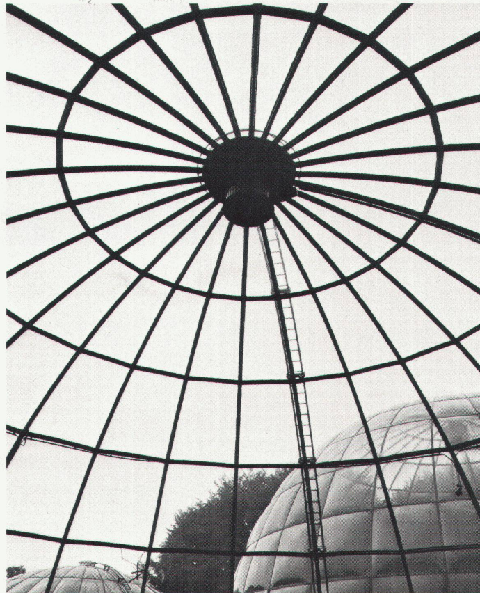
Auf dem Höhepunkt der Kuppel ist der Ventilator in die Tragkonstruktion eingebaut
